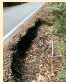
西山町道路脇 法面崩れ対応
